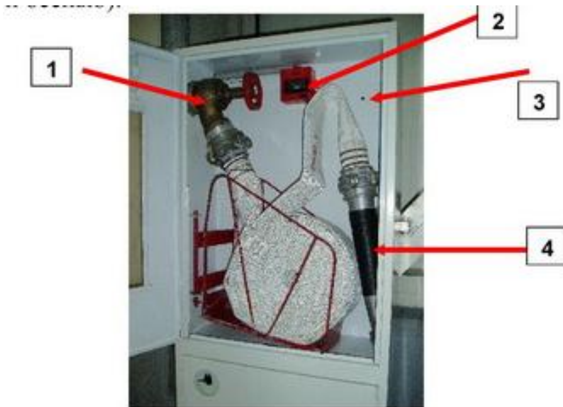
Рисунок 7 Внутренний пожарный кран
